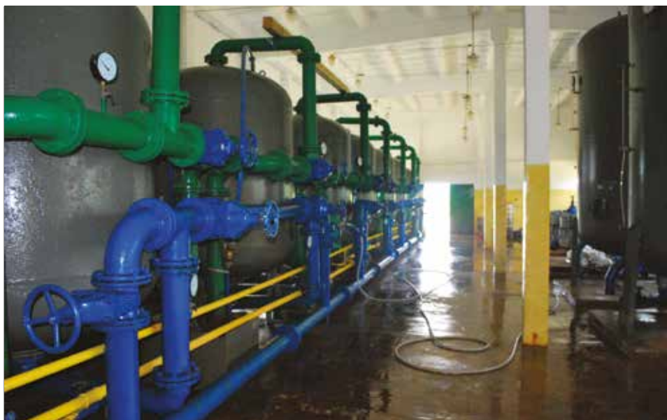
Przepompownia wody w Dobrzejewicach.
